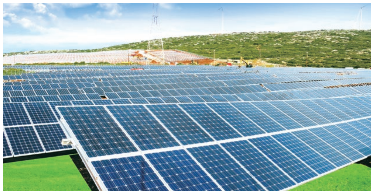
首个欧洲光伏发电EPC项目——希腊115.9兆瓦太阳能光伏发电项目
