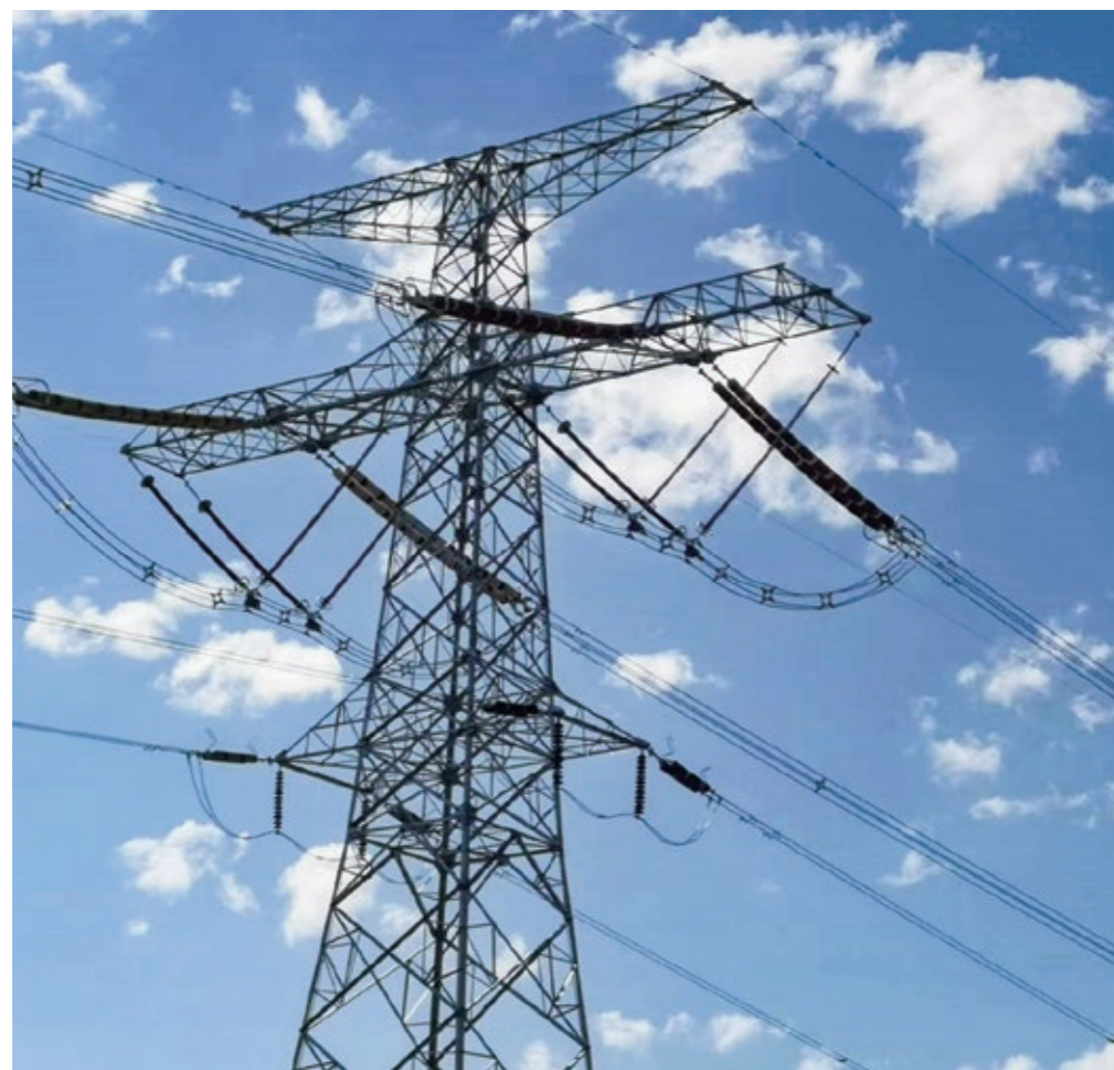
张北柔性直流电网工程
