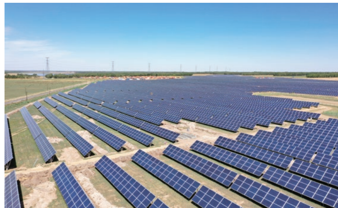
张北县“互联网+智慧能源”800兆瓦示范项目
